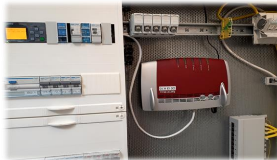
Aufbau eines kleinen Netzwerks in Verbindung mit einer Kleinststeuerung
